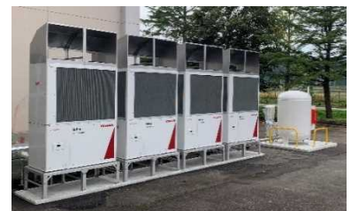
のびっこ広場の 室外機とガスタンク
